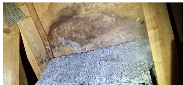
Fuktskjolder ved pipegjennomføring.
