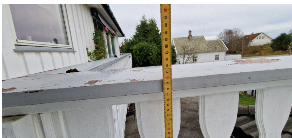
For lavt rekkverk og malingsflass.
