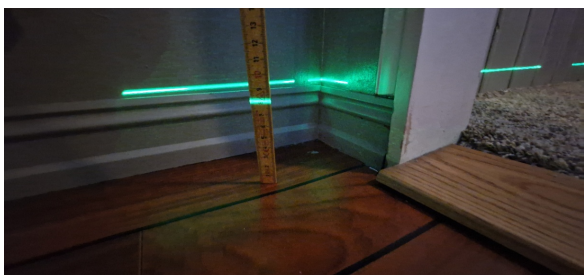
29mm høydeavvik gjennom hele rommet på soverom.
