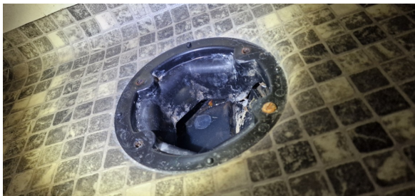
Plastsluk under innredningen.
