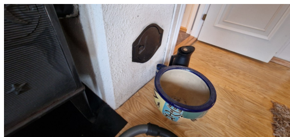
Manglende ubrennbar plate.
