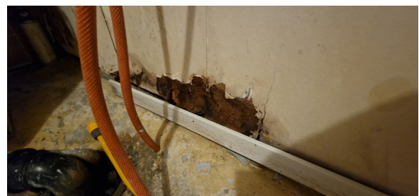
Fuktskader på vaskerom.
