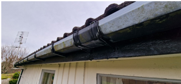
Lekkasje fra skjøt på takrenne.
