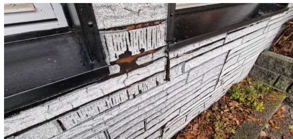
Svelling og sprekkdannelser på dekorplater.
