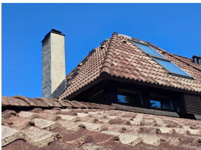
Det er enkelte takstein med lufting, men dette er ikke en fullstendig løsning.
