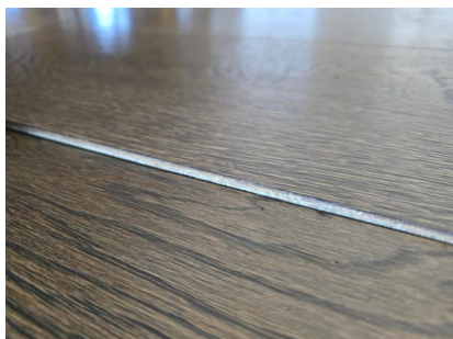
Skade i parkett i stue/kjøkken i 1. etg.
