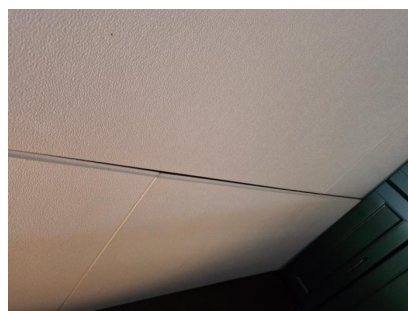
Feil i himling i stue/kjøkken i stue/kjøkken i underetasjen.
