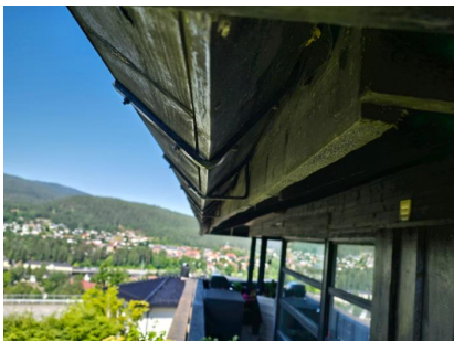
Skjevhet i konstruksjon.
