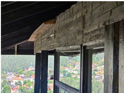
Skjevhet i konstruksjon.
