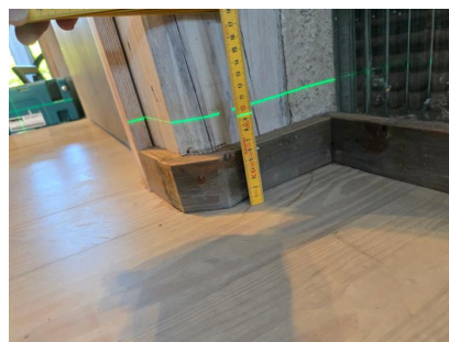
Bildet viser høydeforskjell på gulv/etasjeskiller i leilighet i 2.etg.
