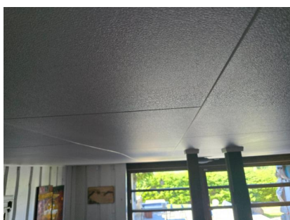
Skjevhet i himling i stue/kjøkken i leilighet i underetasje som indikerer etasjeskiller.
