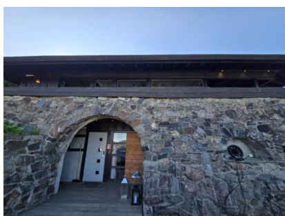
Bildet viser at det er veranda over innredede rom.
