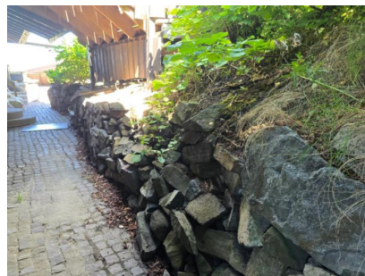
Skjevheter i natursteinsmur.
