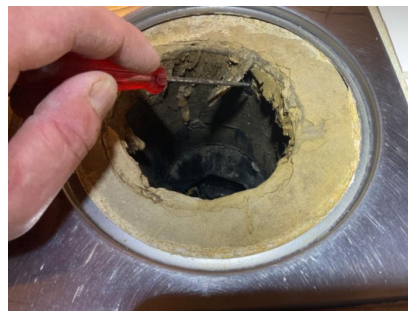
Bildet viser plastsluk og smøremembran, men membran har ikke en tett tilslutning til klemring
