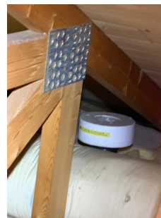
Bildet viser lufteør som er avsluttet med vakuumventil på kaldt loft.
