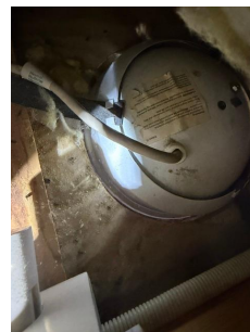
Bildet viser at dampspærre er utett rundt bøttelamper.
