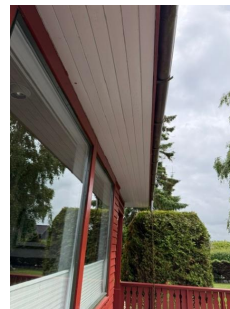
Bildet viser at det ikke er luftespalte i takutstikk.
