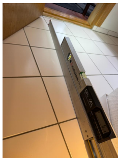
Bildet viser fall mot dørterskel uten membranoppbrett.
