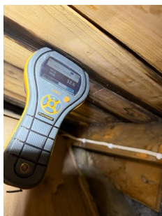
Bildet viser tørr fuktmåling ved fuktmerker ved pipe.
