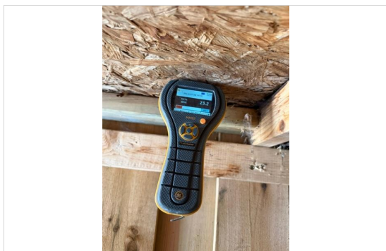
Bildet viser høy fuktmåling i undertak av OSB.
