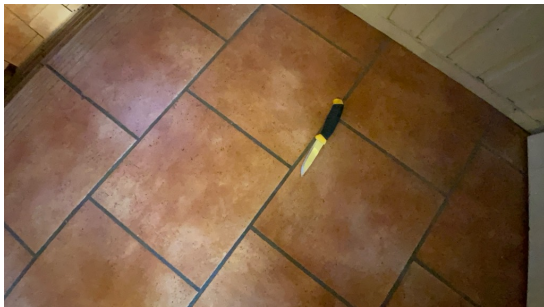
"Bom" i enkelte fliser på gulv.
