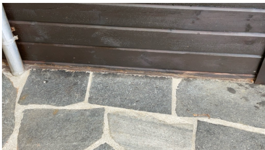
Ikke luftespalte mellom kledning og platting ved inngang.
