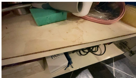
Fuktskader i kant av hylleplate i skap under vask.
