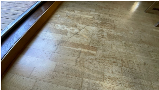
Parkett i stue er slitt ved terrassedør.
