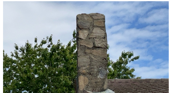
Riss i fuger på pipe over tak.
