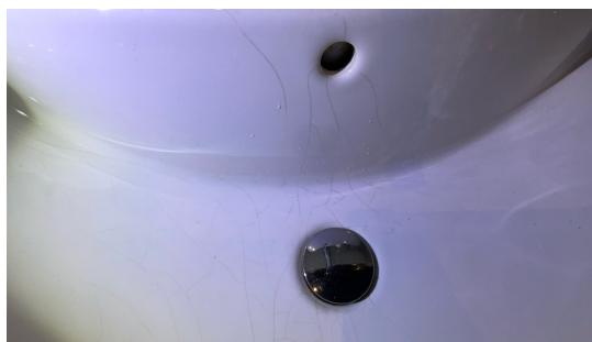
Sprekker/krakkelering i servant.
