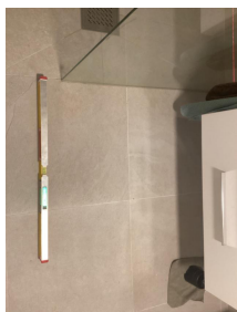
Svakt fall fra dusj og inn i rommet.
