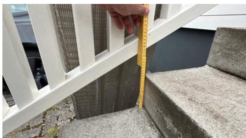
Åpning i rekkverk
