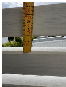
Åpninger i rekkverk er større enn maksimalt 2 cm
