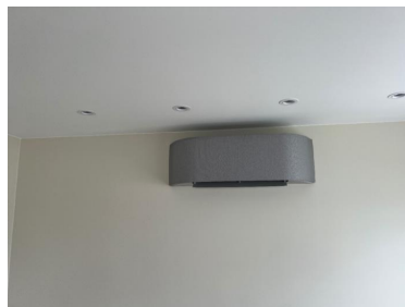
Varmepumpe i stue 1.etasje
