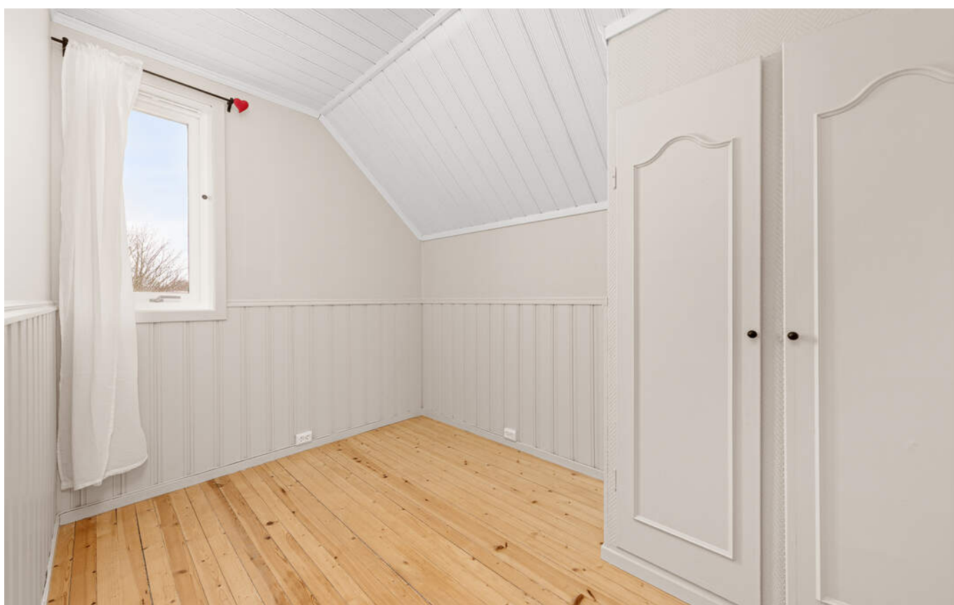
2 små soverom i 2.etasje har for små vinduer i til å oppfylle krav til dagslysflate og rømningsvei.
