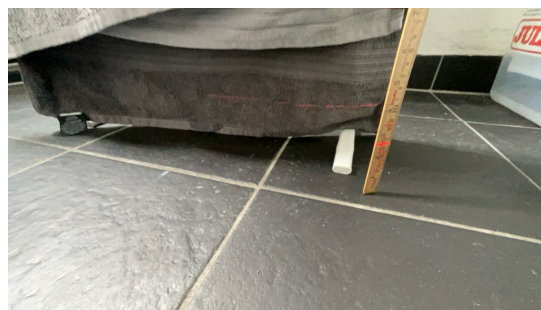
Motfall gulv vaskerom.
