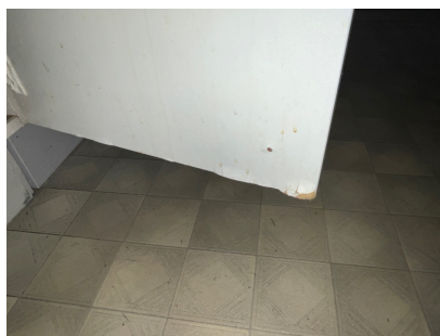
Skader i nedkant dør.
