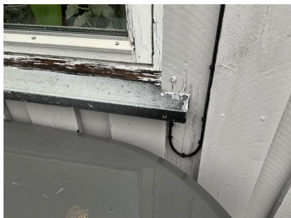
Utskiftning må vurderes.
