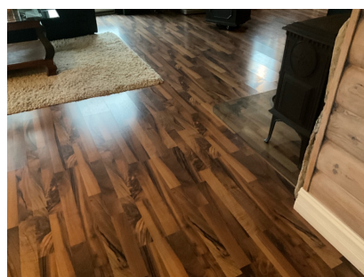
Synlig buing/ujevnheter i laminat stue
