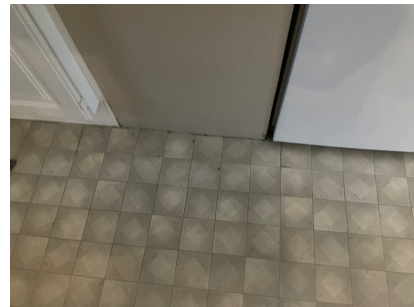
Ikke synlig utsparing i gulv
