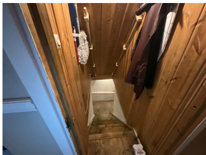
Bratt trapp til kjeller, det er montert håndtak i taket.
