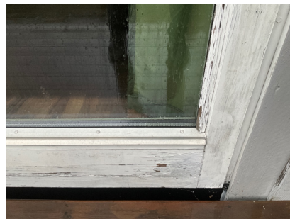
Terrassedør er vær/alders slitt
