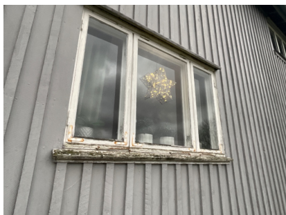
Enkelte koblede vinduer fra opprinnelig byggeår. Utskiftning må vurderes.
