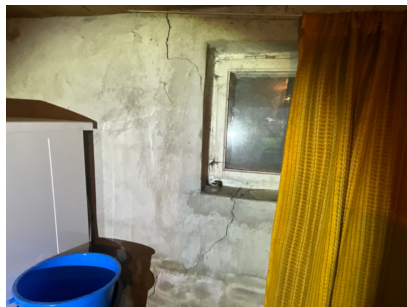
Sprekker i grunnmur
