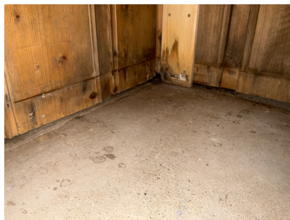
Råte/fuktskjolder i utforingen
