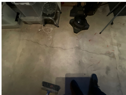
Sprekker i det støpte kjellergulvet
