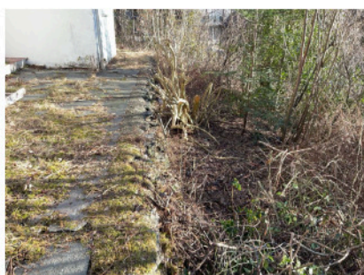
Natursteinsmur uten fallsikring/rekkverk.
