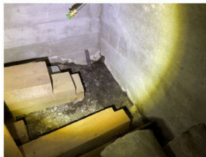
Fuktinnsig på terreng/grunn bakre del.
