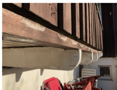
Svikt/nedsikt på bæring balkong fra hovedsoverommet.
