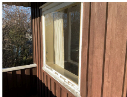
Malingsavflassing på vinduer.
