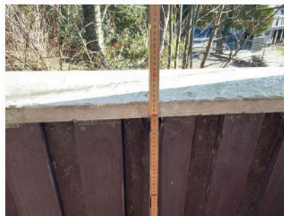
Rekkverk er generelt for lave og under 90 cm.
