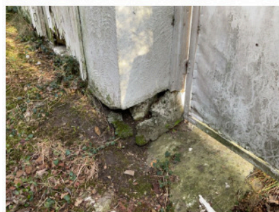
Deler av mur står ikke på frostfritt underlag, her i hjørne mot vest.
