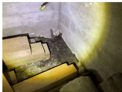
Fuktinnslag sett i krypkjeller.
