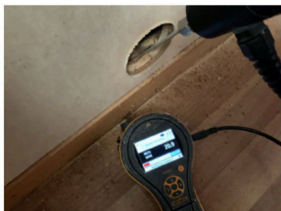
Fuktmålt i påforet yttervegg med for høye verdier.
