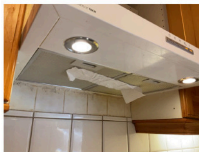
Ventilator funksjonstestet med papir.
