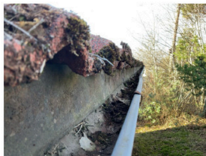
Løvansamling i takrenne.
