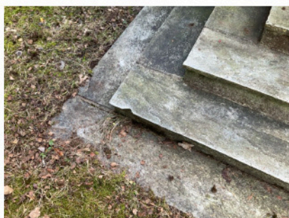
Skader på enkelte skiferstein.
