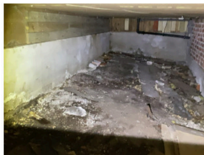
Grunn i krypkjeller som er fuktig.
