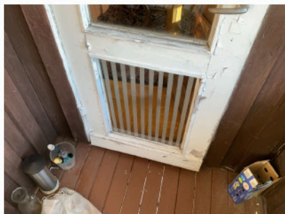
Oppsprikking/malingsavflassing på dører.
