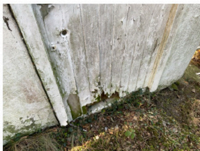
Råteskader på dør til krypkjeller.
