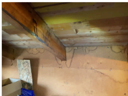
Eldre fuktmerker på overflater/plater.
