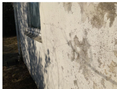
Malingsavflassing på mur.
