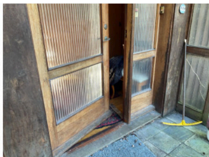
Værslitt hovedytterdør, sprikk i glass.
