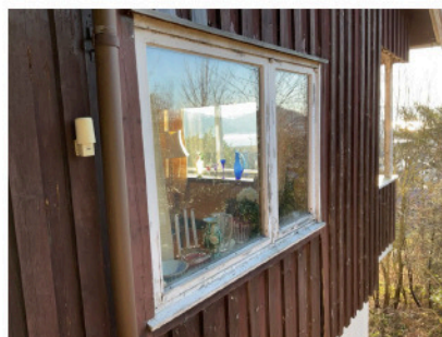
Malingsavflassing på vinduer.
