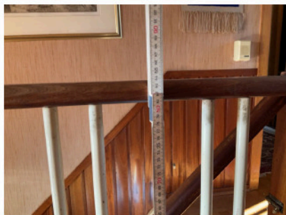
Rekkverk under 90 cm.
