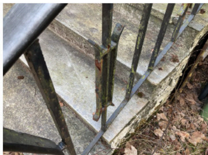
Rust på smijernsrekkverk.
