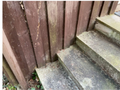
Bordkledning kommer for nær eller under underlaget.
