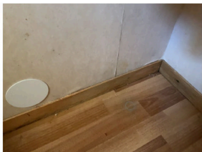
Fuktskjolder på innside vegger mot krypkjeller.
