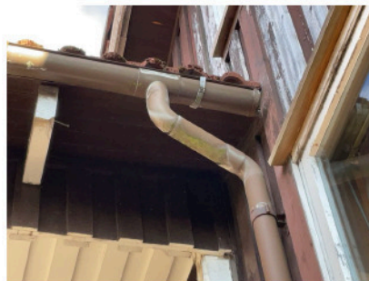
Lekkasjer fra renneskjøter/tappestykker.
