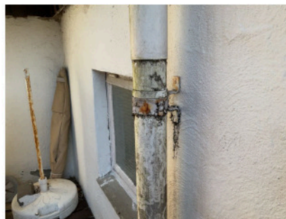
Rust på festklammer for nedløpsrør.
