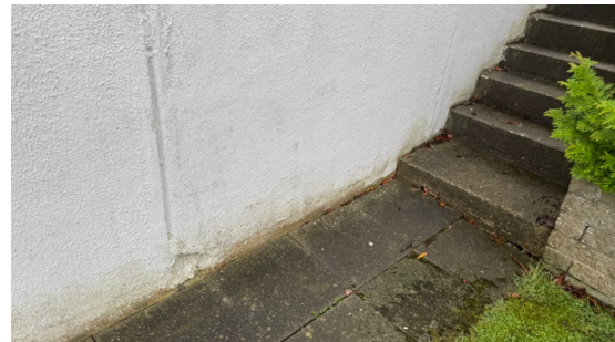
Sår i grunnmur av ukjent årsak.
