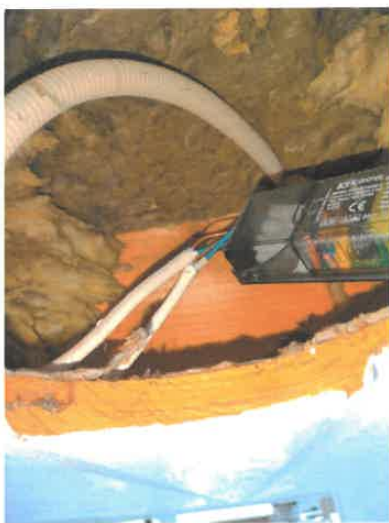
Bilde 1 Pr kabel
