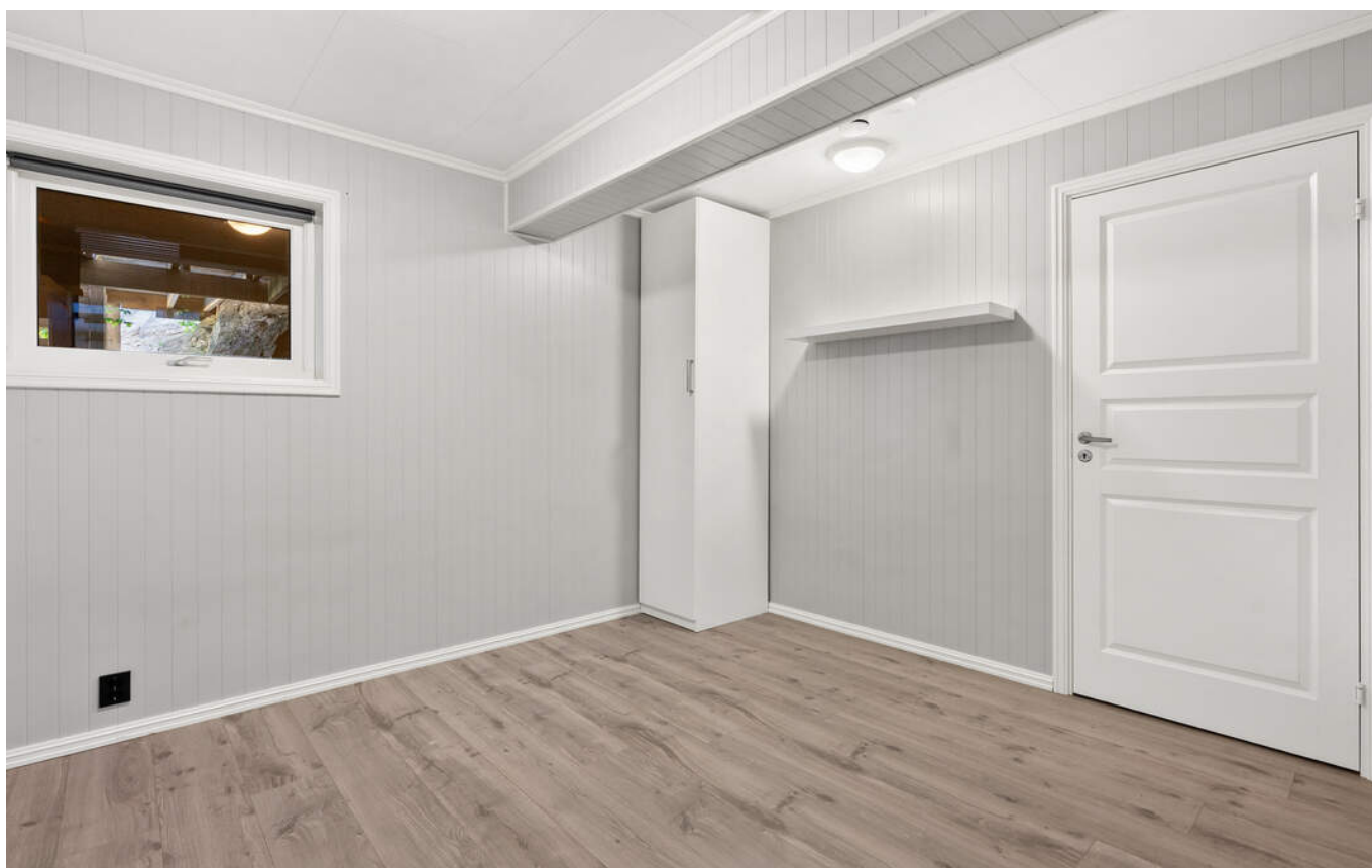
Innredet rom i kjelleren som i dag benyttes til soverom. Rommet er opprinnelig godkjent som bod, og ikke godkjent som soverom.
