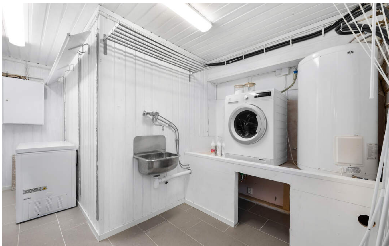
Rommet har skyllekar, opplegg for vaskemaskin og en 194 liters varmtvannsbereder fra 2008. Fliser på gulvet og lysmalte vegger og himling.
