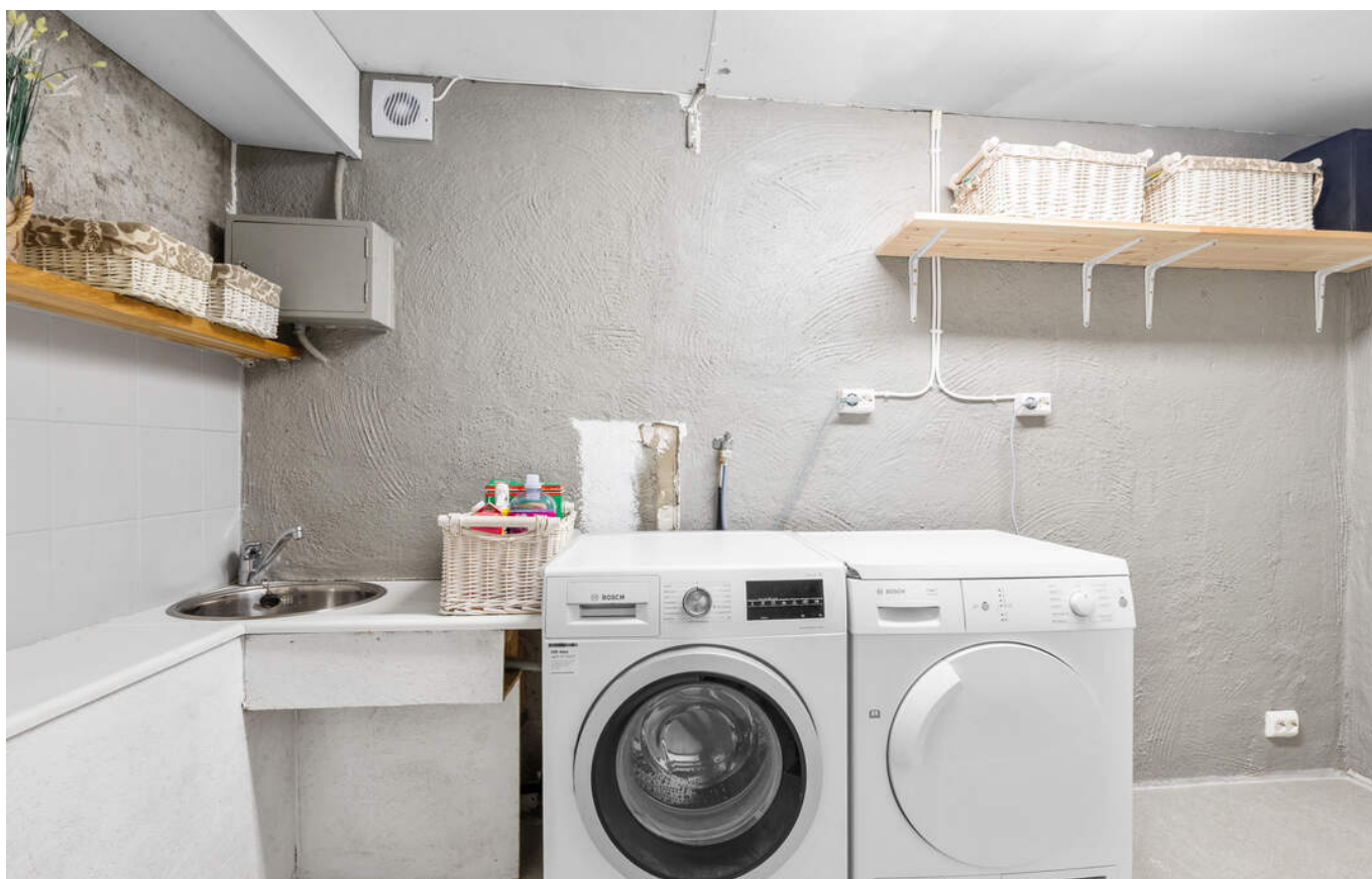
Kjeller er innredet og benyttet som vaskerom, ikke godkjent.
