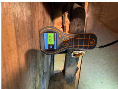
Manglende ventilering og fuktighet i undertak
