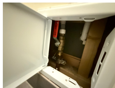
Stoppekran i inspeksjonsluke.
