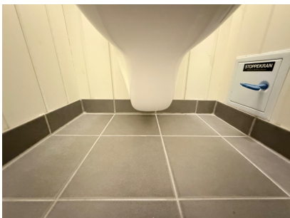
Det er ikke dreneringshull fra innebygget sisterner
